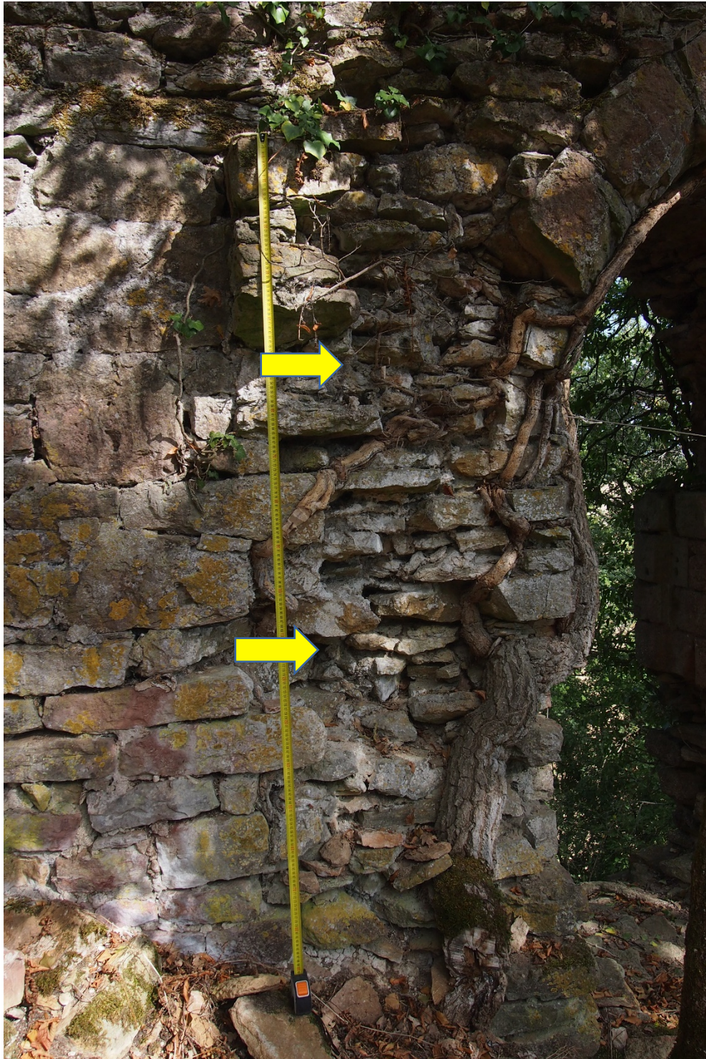
Fig. 9 – Les flèches jaunes indiquent l'arrachement visible dans le mur nord du logis d'Amboise. La mire indique une hauteur d'arrachement de 1,90 m.
